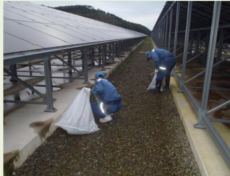
OTK土湯天沼発 太陽光発電所内
