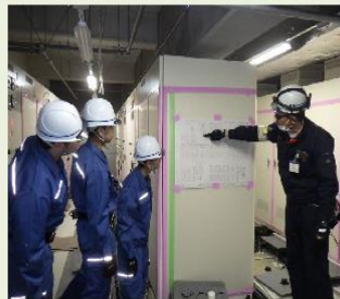
電気室視察 単線結線図 説明状況
