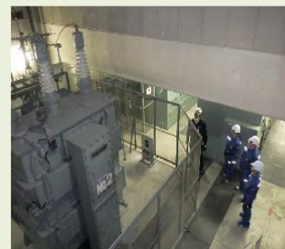
特高電気室視察状況
