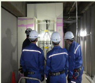
高圧ケーブル接続盤 視察状況
